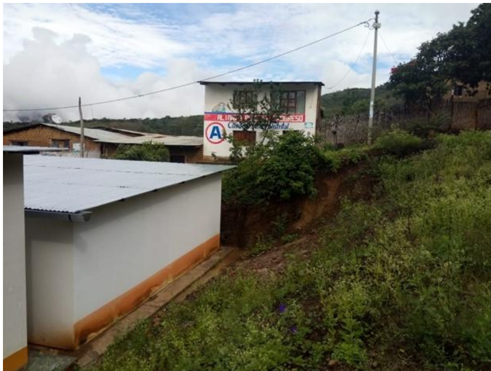
Zócalo del módulo con afectación de las aguas lluvias que cae de las partes altas
